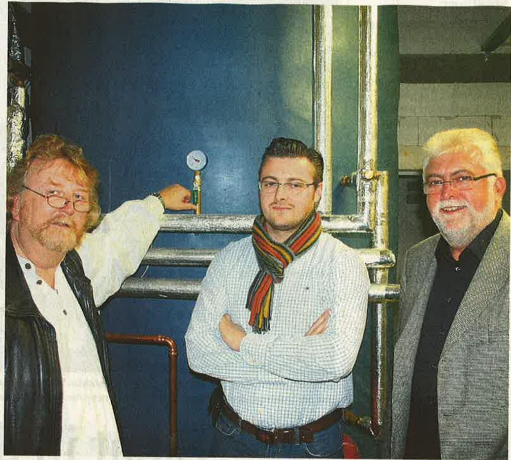
Architekt Christian Teege (l.), Geschäftsführer Alexander Landgraf und Unternehmensgründer Reinhard Landgraf führten durchs Sonnenhaus, stellten auch den großen Pufferspeicher vor. FOTO: HEIKO HOHENHAUS
